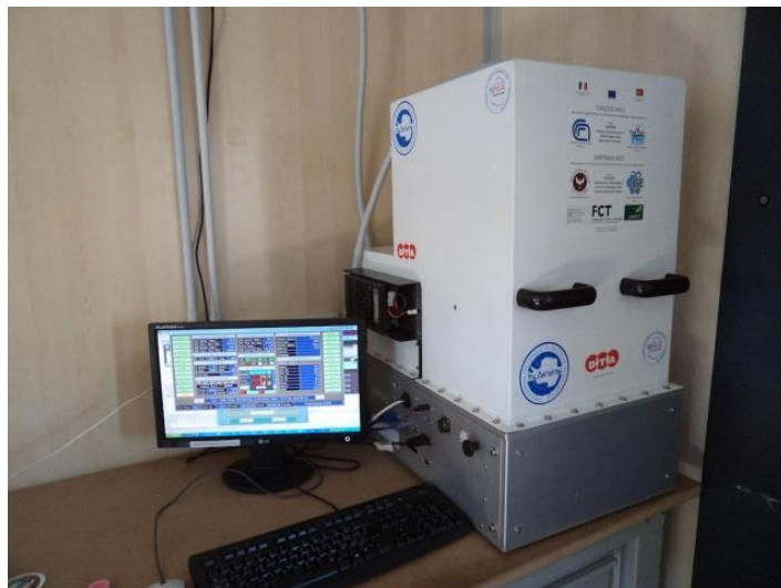
Figura AZ3.02-1 - GASCOD-NG1/SPATRAM-MZS installato all'interno del PAT
