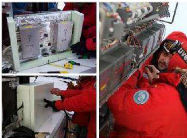
Fig. 4 – L'installazione dei due riscaldatori aggiuntivi da 50 W e delle due sonde di temperatura PT100 all'interno delle scatole elettroniche attaccate al criostato, e di una terza sonda di temperatura PT100 sulla parete laterale esterna del criostato. electronic boxes.
