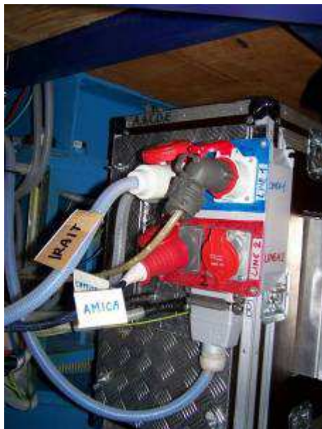
Fig. 2 – Il quadro di alimentazione trifase (5 poli) per ITM, AMICA e CAMISTIC.
